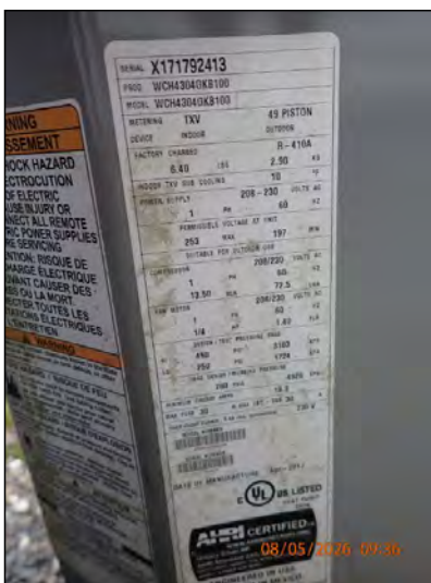
2017 Grandaire 2.5 Ton Unit
