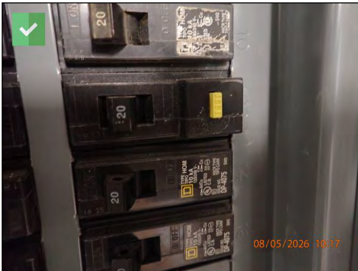
GFCI Tripped/Reset (Sub Panel)
