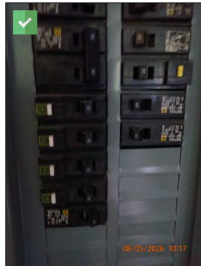
AFCI Tripped/Reset (Sub Panel)
