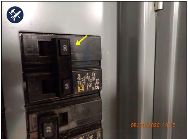
1 - Water Heater (Sub Panel)
